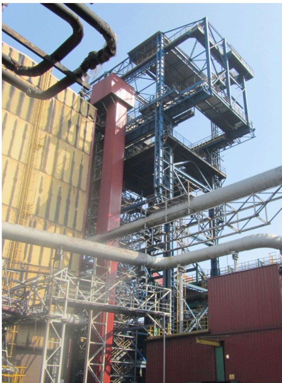
Jednotka suchého hašení koksu pro baterie č. 3 a 4.
