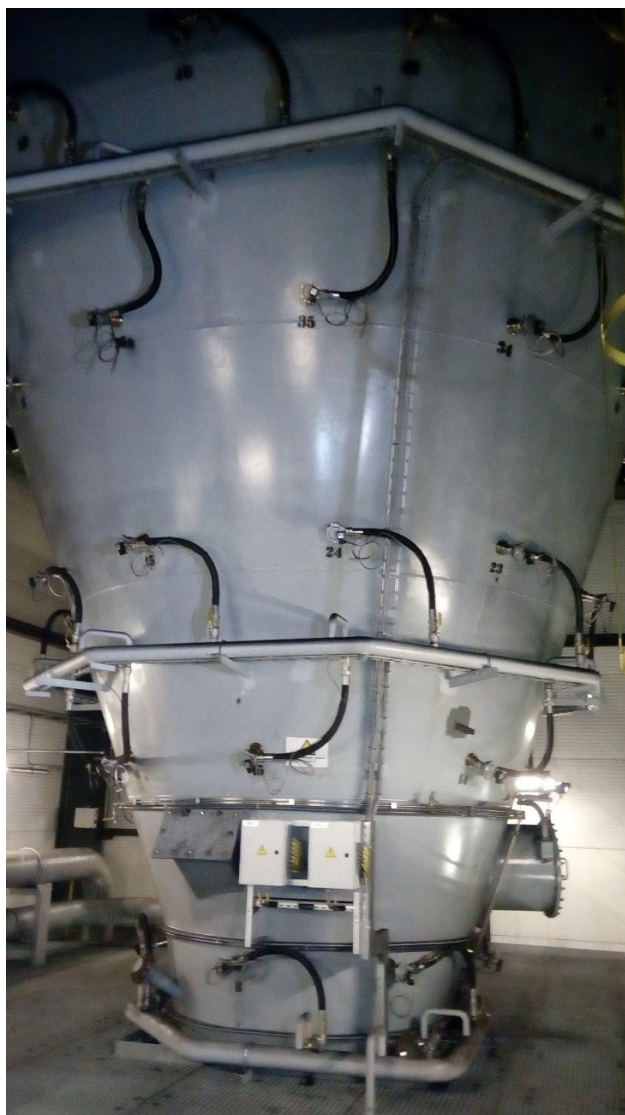
Systém pulzních trysek na zásobníku surového uhlí
