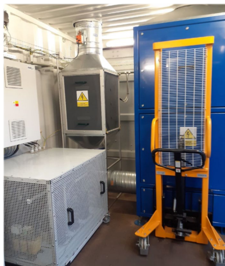
Obrázek 2 Zařízení Plazkat – vnitřní pohled
