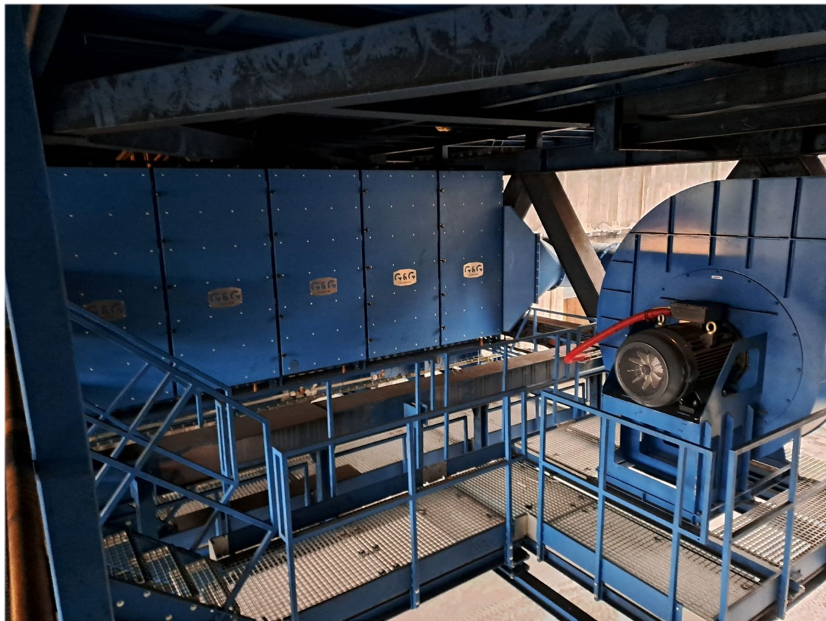
Obrázek 4 Filtry a ventilátor dodatečného odprášení
